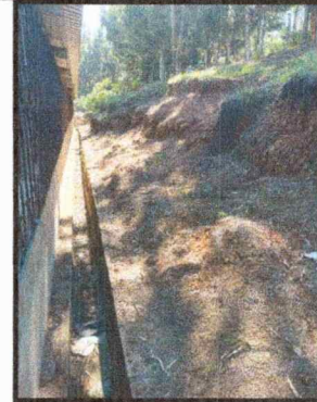
Foto 20: Es necesario ampliar muro de contención.
