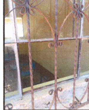
Foto 2: Se cambiarán vidrios que estan en mal estado
