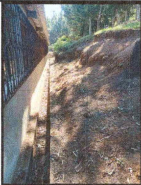
Foto 21: Prioridad colocación de columnas.
